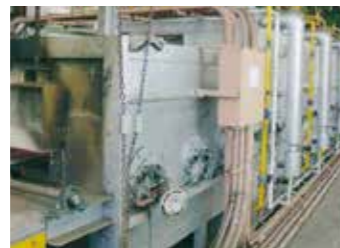
ローラーハース炉 Roller Hearth Furnace
