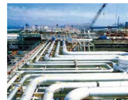
プラント配管 Pipes for plant
