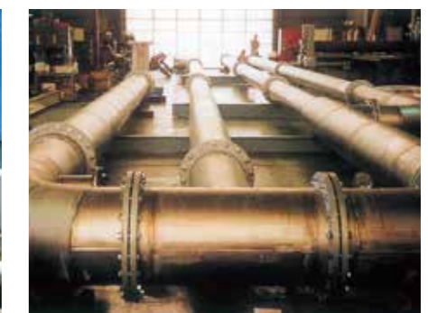
LNG配管 LNG Pipelines
